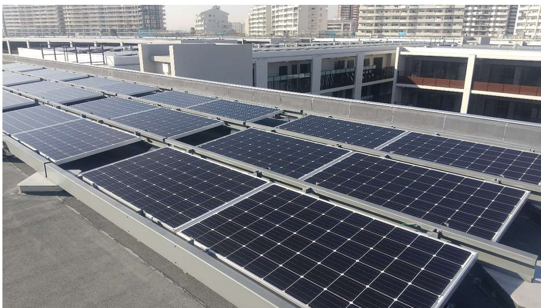
▲「ザ・パークハウス 新浦安マリンヴィラ」第1工区 太陽光パネル
