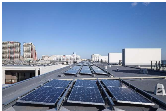
▲ザ・パークハウス 新浦安マリンヴィラ 屋上太陽光パネル
